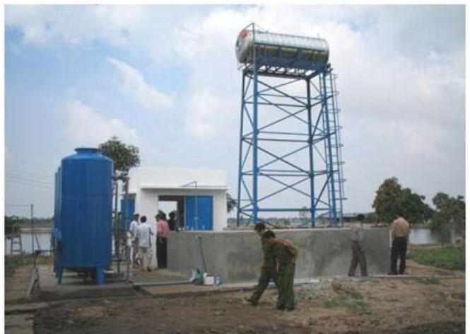
Hệ thống xử lý nước nhiễm phèn sắt Katox tại An Giang
