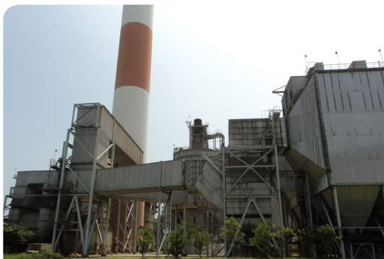
Thiết bị lọc bụi tĩnh điện tại nhà máy nhiệt điện Phả Lại
