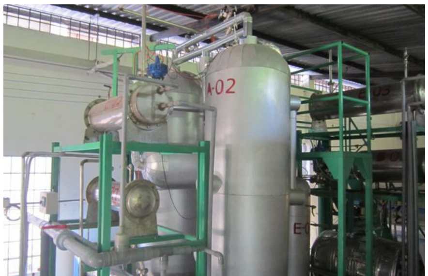
Hình 1: Hệ thống tinh luyện cồn tại RPTC
